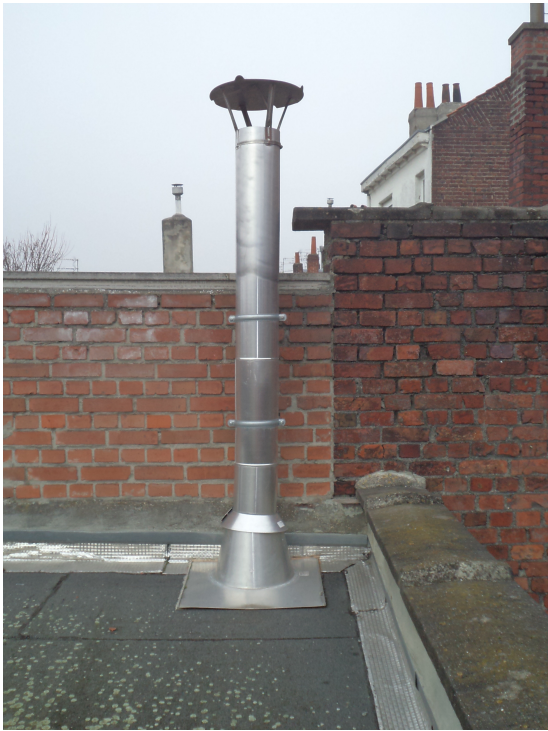
FIGURE 16 – sortie des fumées à l’extérieur
